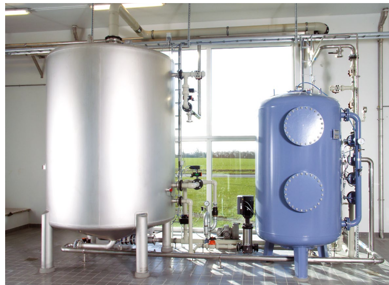
Дегазация растворенных в воде газов: углекислый газ, метан, сероводород как предусловие для оптимальной фильтрации. На фото: дегазатор и напорный фильтр для пивоварни.
